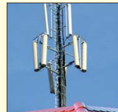
Mobilfunkantennenanlage auf Hausdach
